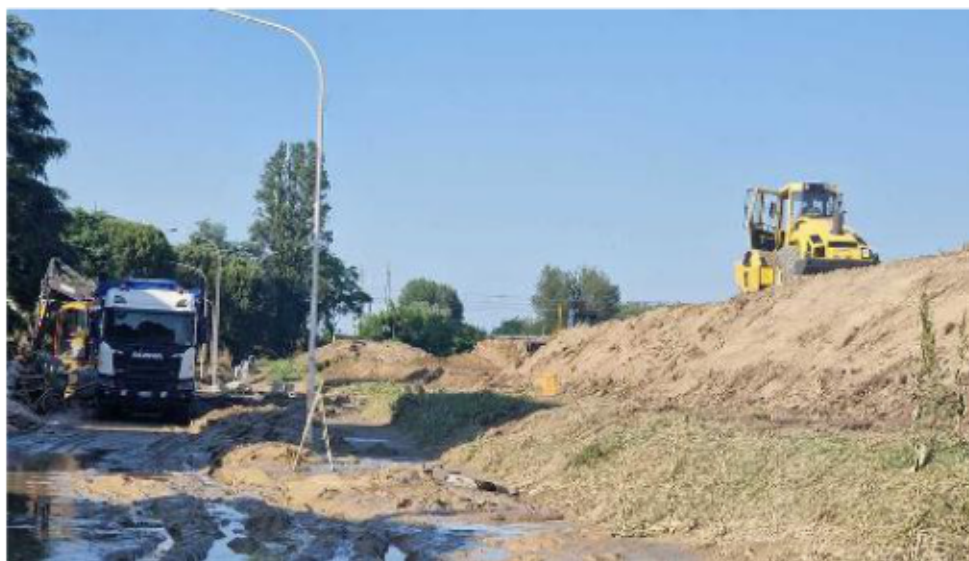
I lavori per ricostruire l'argine nel Borgotto, in via Fratelli Bandiera. Sotto quanto ricostruito a Saldino (foto Tedioli)
